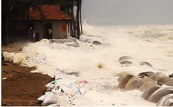
a) Sóng lớn trong bão tràn qua đỉnh kè tại bãi chính biển Cửa Đại
