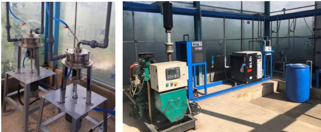
Hình 1.23. Thiết bị HGRPB trong mô hình xử lý bùn thải nhà máy bia Sài Gòn tại Đắc Lắc [149]
