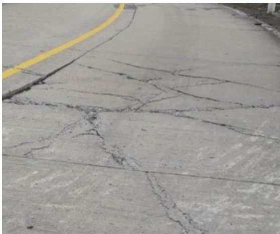
c. Vết nứt trên mặt đường
