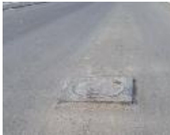
d. Nắp cống thoát nước lắp dương
